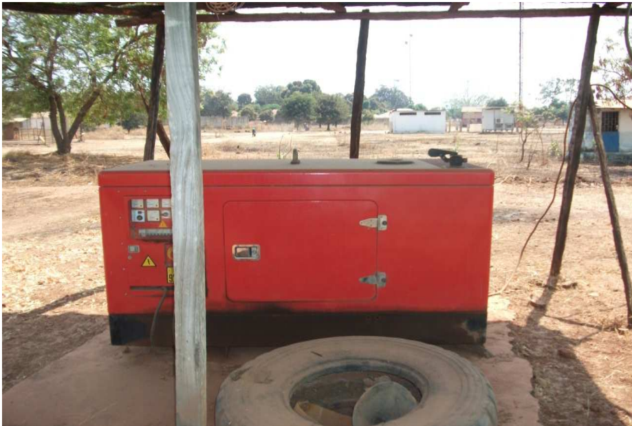
Figura 7: Gerador da RCB
