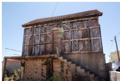
31. Palheiro degradado na Costa de Lavos. Sistema entramado sobre sistema enfunecado.
