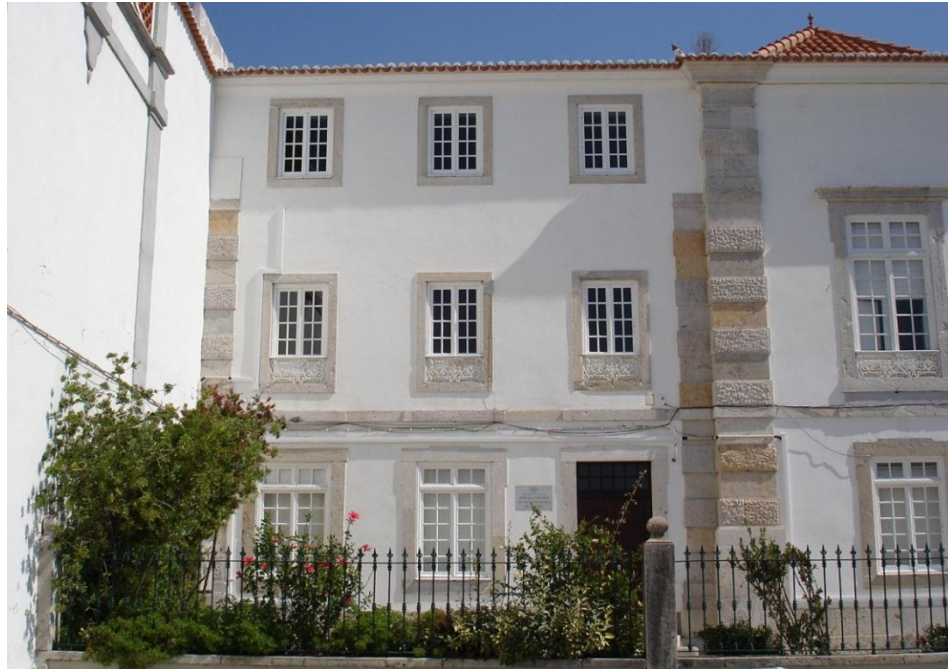
Fig. C4. 4 – Corpo anexo à muralha da fachada sul. Note-se a quebra nas pilastras.
