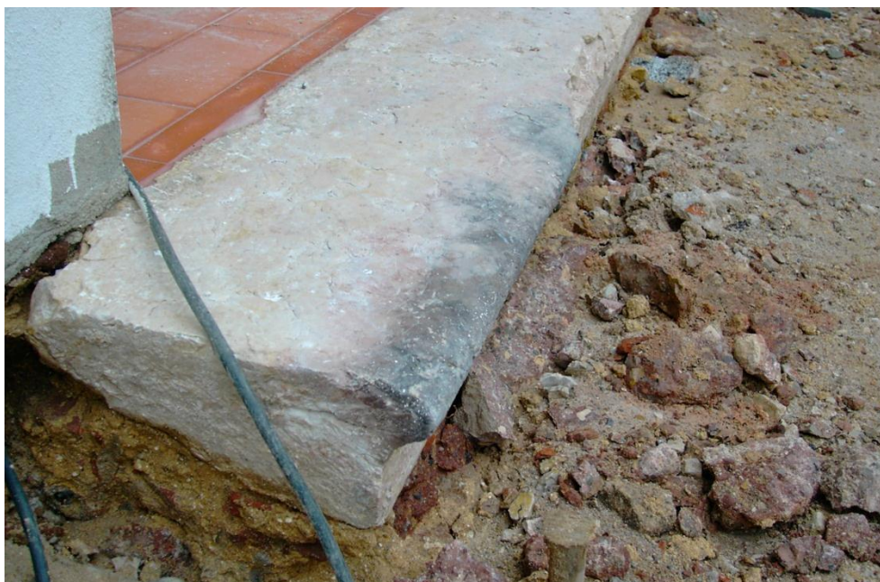
Fig. C3. 29 - Marca do incêndio na pedra de bordadura do claustro. Foto Engº Francisco Silva Alves. Set.2002.
