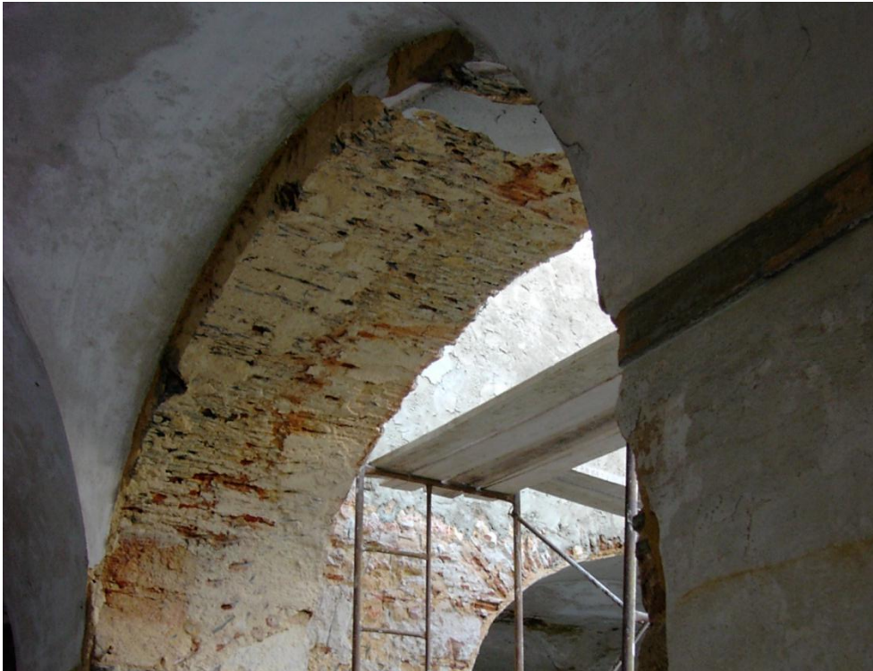
Fig. C3. 30 - Marca do incêndio nos arcos do claustro. Foto Engº Francisco Silva Alves. Set.2002.
