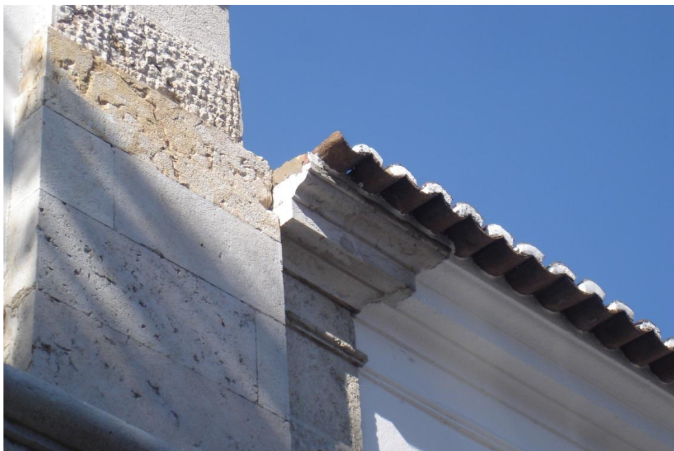
Fig. C4. 16 - Encontro do beirado do corpo do claustro, com o corpo sul do edifício. Note-se a ausência de acabamento do topo da cornija.
