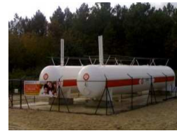
Figura 16 - Reservatórios de Gás Fonte: Adaptado do site da Galp Energia
