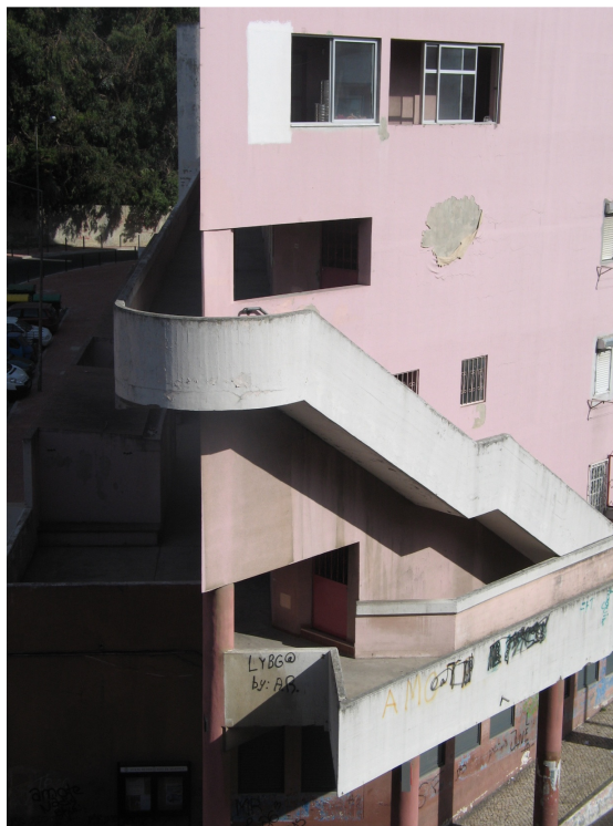
Figura 7. Qualidade construtiva. Bairro dos Lóios, “Pantera Cor-de-rosa”
