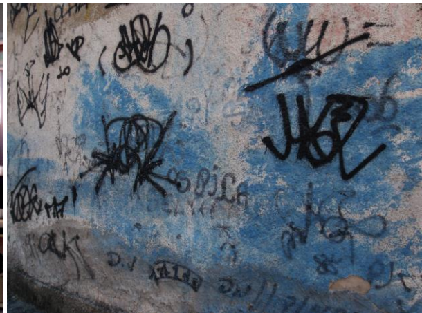
Figura 34 – Pichação nos muros da escola
