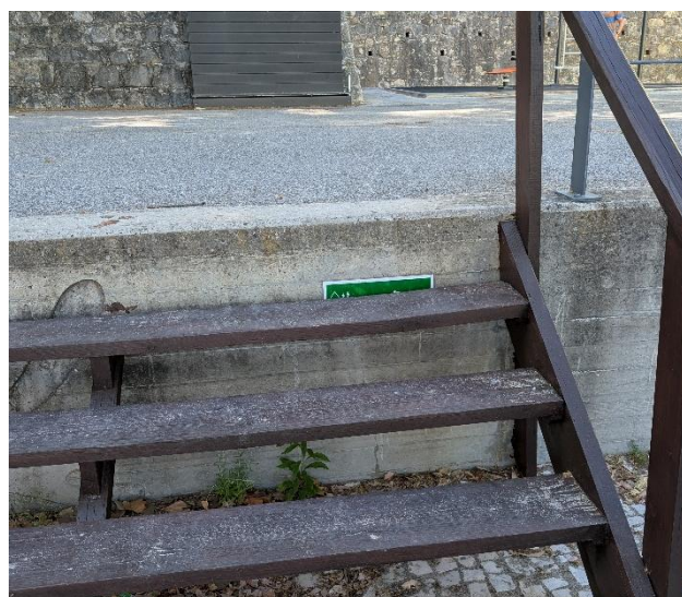
Figura 12 - Escadas a cobrir um sinal de evacuação.
