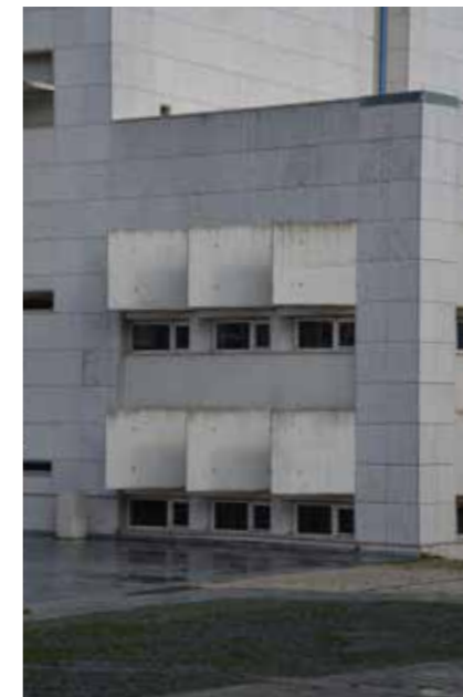
Figuras 313 e 314 - Fotografias do interior e exterior do edifício 2, Iscte-iul. © Vera Morais
