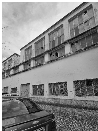
Figura 44 - Fachada da Fábrica Barros, Av. de Pádua. Fonte: fotografia de autoria própria, 2025.
