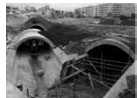
73N. Obras de canalização da ribeira de Alcântara na zona de Benfica, fotografia retirada em 1967 ©Camãra Municipal de Lisboa
