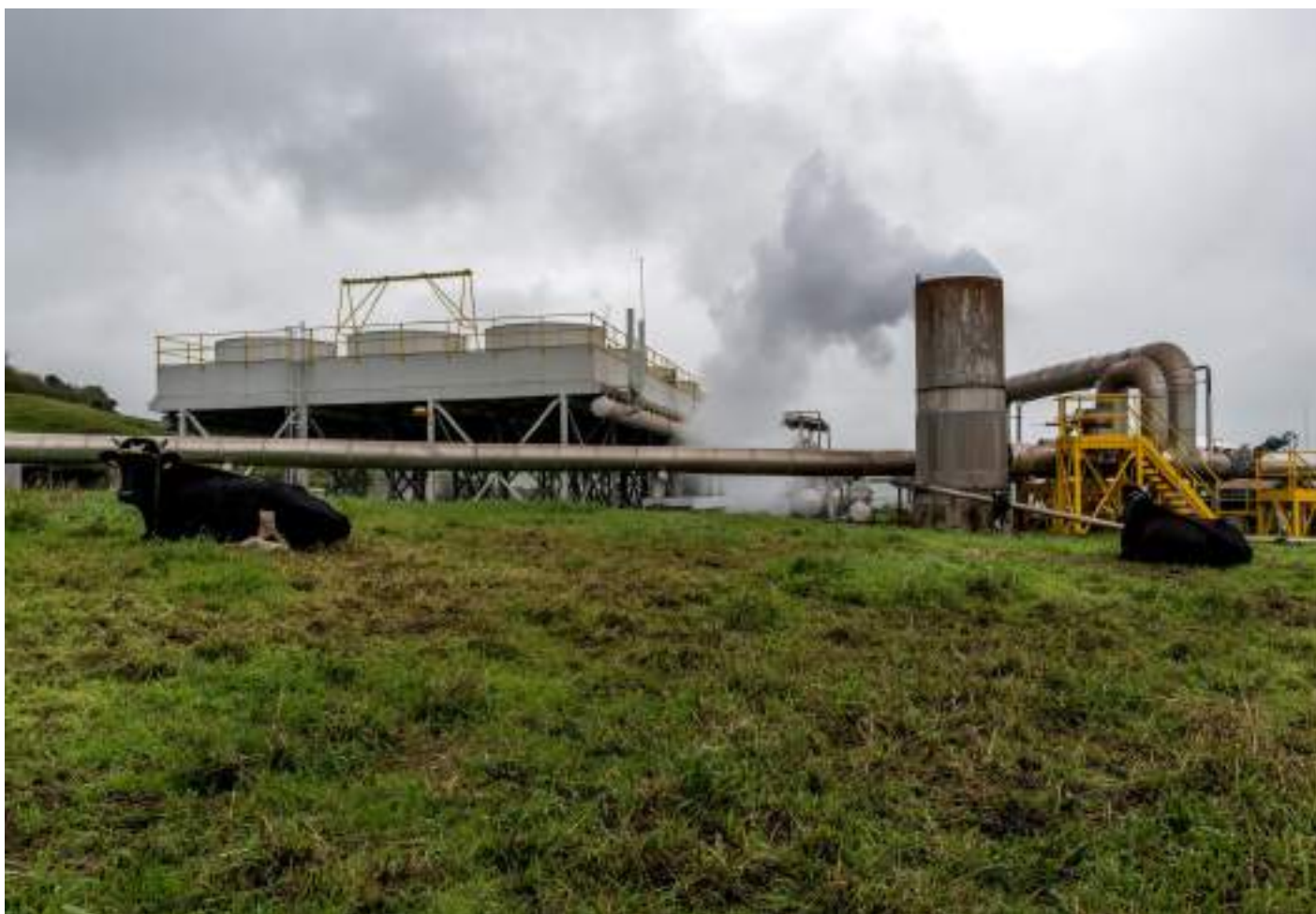
183. Central Geotérmica da Ribeira Grande, São Miguel, Açores, 2022, Inês Rodrigues. Fonte: Ordem dos Arquitetos.
