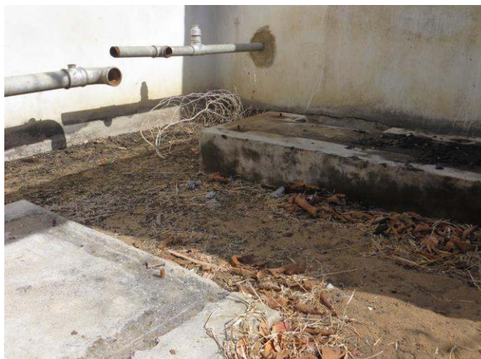
Photo 2 : Ancienne station de pompage abandonnée du village Ujamaa de Kipo d'où la pompe à eau détériorée a été retirée (Fouéré, 2016)
