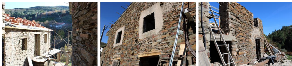
Fig. 8 - Reconstrução da casa da minha bisavó, Maria do Céu, com preservação do xisto e portadas em madeira. Fonte: a autora. 24/12/2022
