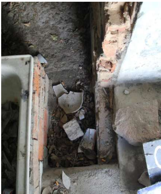
Fig. 3.27 - Pormenor do desnível do piso no interior das Retretes. É de notar o avançado estado de degradação da estrutura. Fotografia da autora, novembro de 2022.
