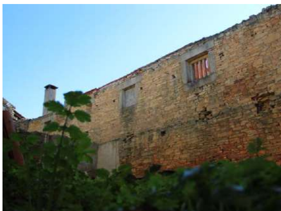
Fig. 3.15 - Edifício em ruína (perspetiva interior). Fotografia da autora, fevereiro de 2023.
