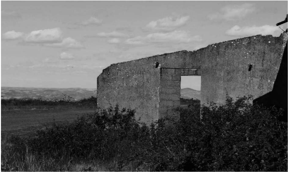
Fig. 1.21- Estaleiro no Alto da Carvalhosa abandonado (Antigo edifício de armazém). Registo do Autor. 2023
