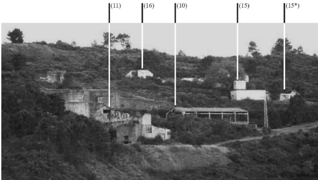
Fig. 2.11- Edifícios em elevado estado de ruína no topo da Carvalhosa. Cristiana Fevereiro. 2015 204
