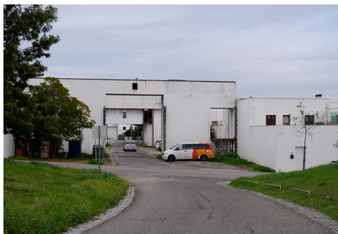
016 - Conduta com reboco , Daniel Gimenez, 2022
