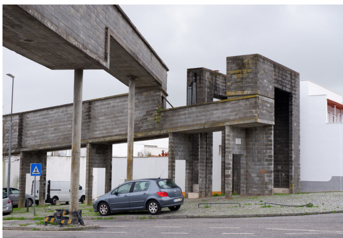
015 - Conduta sem reboco , Daniel Gimenez, 2022
