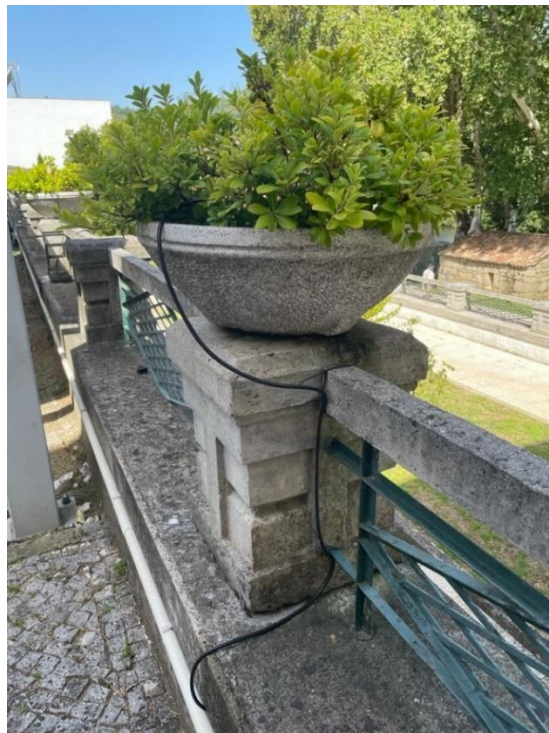
Figura 4. Instalação de rega automática num dos vasos da área verde do Hotel. Fotografado por
