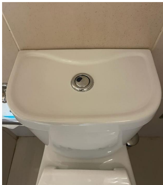
Figura 14. Autoclismo das casas de banho dos quartos do Hotel com dupla descarga para poupança de água. Fotografado por Madalena Sanches.
