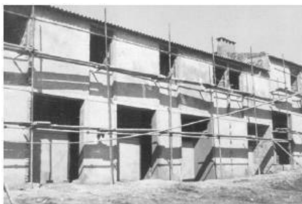
Figura 3.3: Construção do bairro de alvenaria (fonte: Arquivo da Câmara Municipal de Lisboa)
