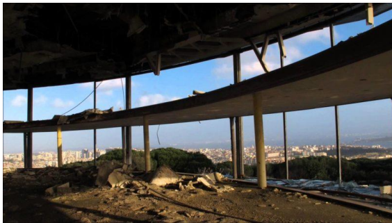
Figura 12 - Abandono do Miradouro.
