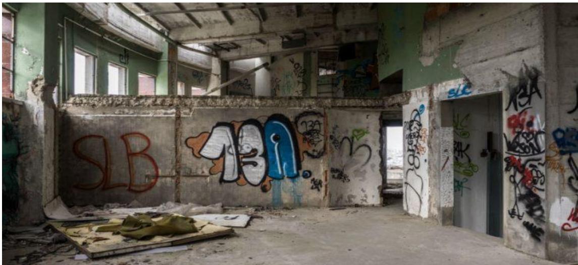
Figura 9 - Abandono do Miradouro.
