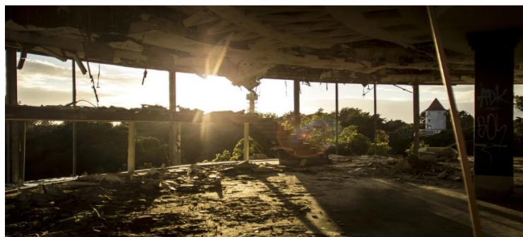
Figura 14 - Abandono do Miradouro.
