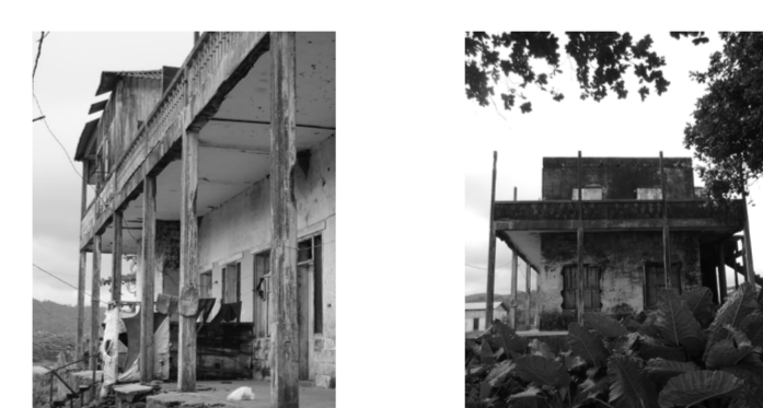
Apropriação da Casa Principal e degradação Fonte: César Santos, Autor
