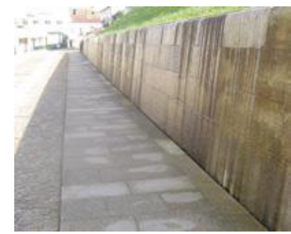
Exige-se assim que os pavimentos que apresentem condições de degradação sejam reparados ou, quando tal não for possível, substituídos por materiais que cumpram os seguintes requisitos: continuidade, segurança e conforto.
