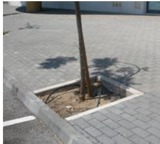
Os problemas das caldeiras de árvores estão muitas vezes associados a danificação de pavimento envolvente, devido ao crescimento abrupto da própria árvore e raízes que se ramificam pelos passeios.
