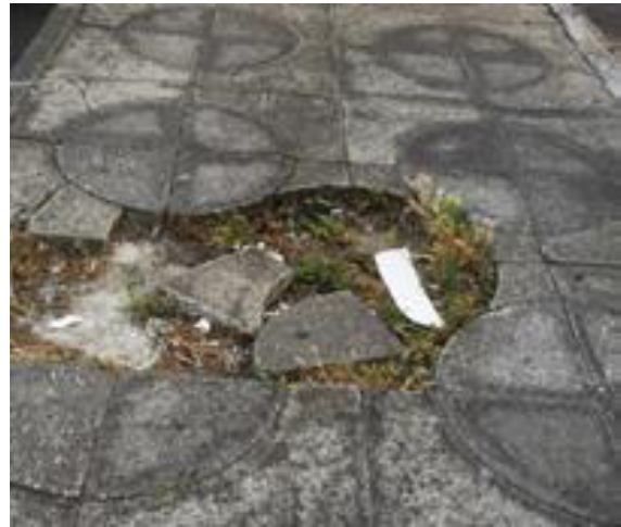
Pavimento degradado - Buracos, desníveis e elementos soltos, são problemas inerentes a esta tipologia de barreira.
