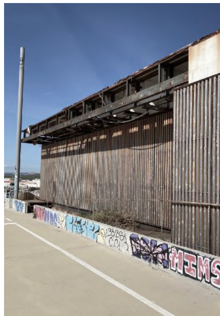
Figura 23 - Registo fotográfico da degradação dos Apoios de Praia
