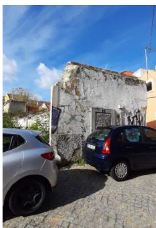
Figura 48: Ruína de um edifício que tende a cair
