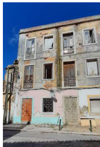
Figura 47: Degradação dos edifícios de habitação e consequente ocupação clandestina
