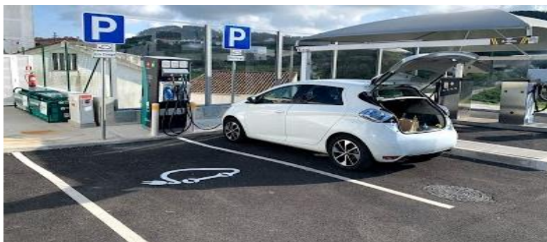
Figura 2.1: Carregadores Elétricos - Posto Venda do Pinheiro
