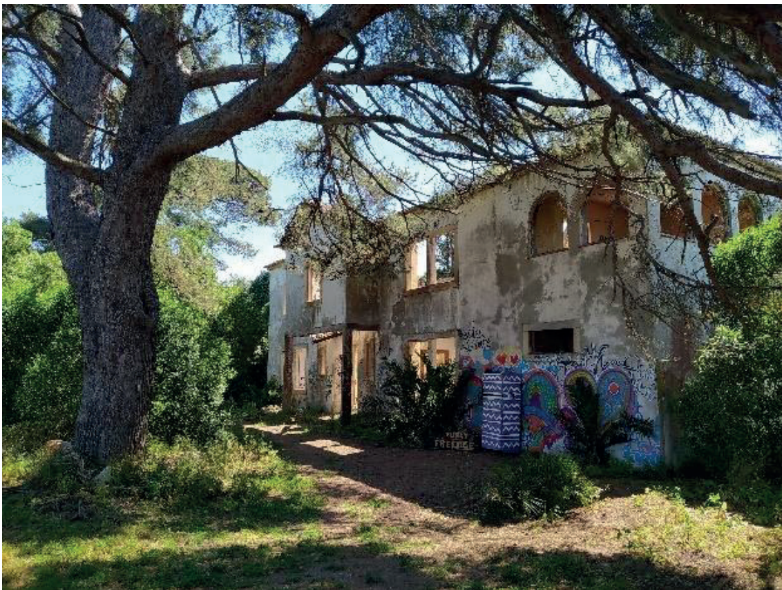
Figura 61 Palacete em ruínas
