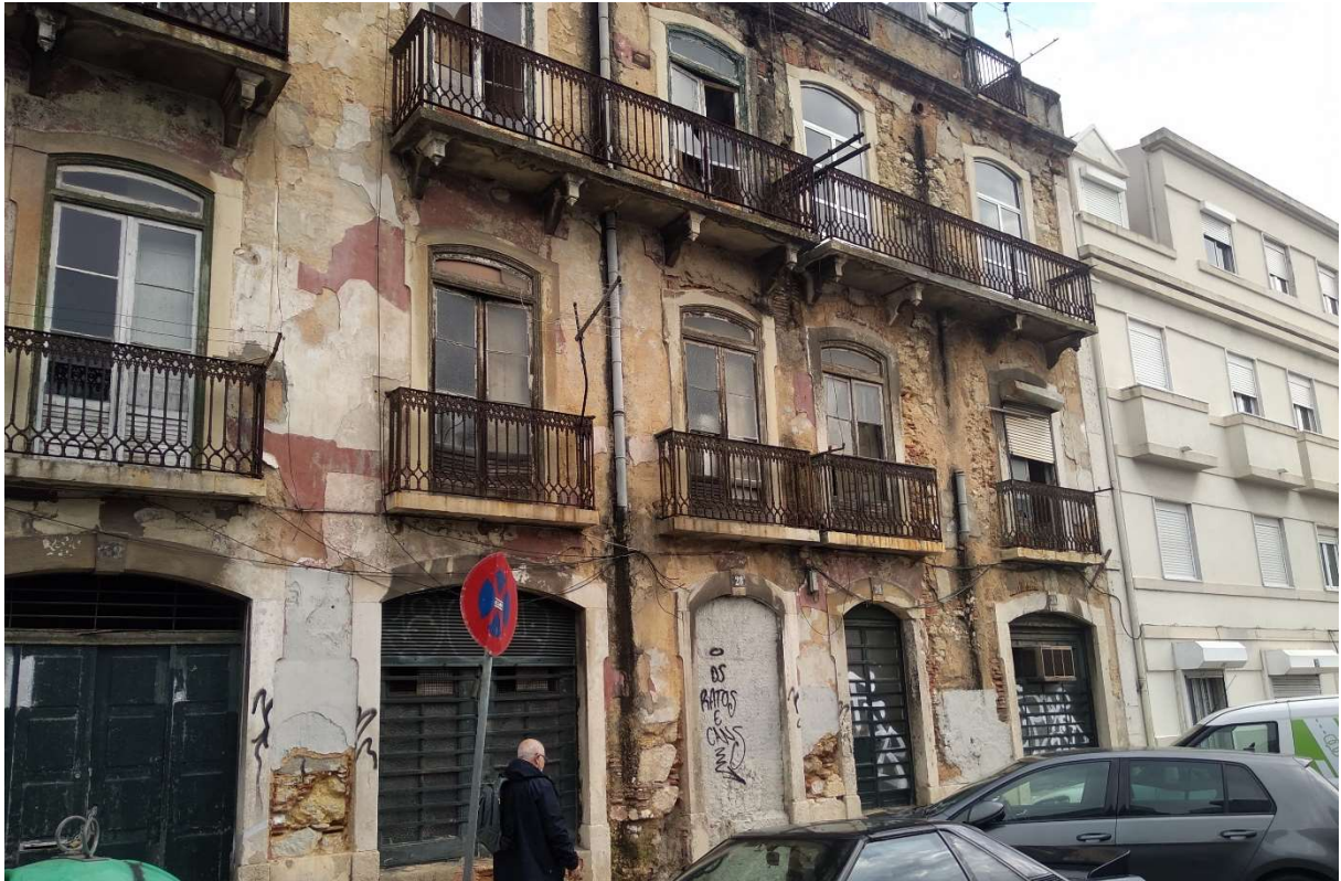
Figura 16 - Fotografia de edifício devoluto no território de Alcântara (Fonte: Autor)
