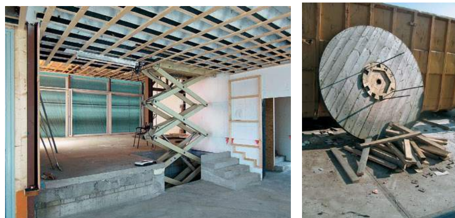
Figura 81 Elevador Industrial e Bobinas de enrolar cabos
