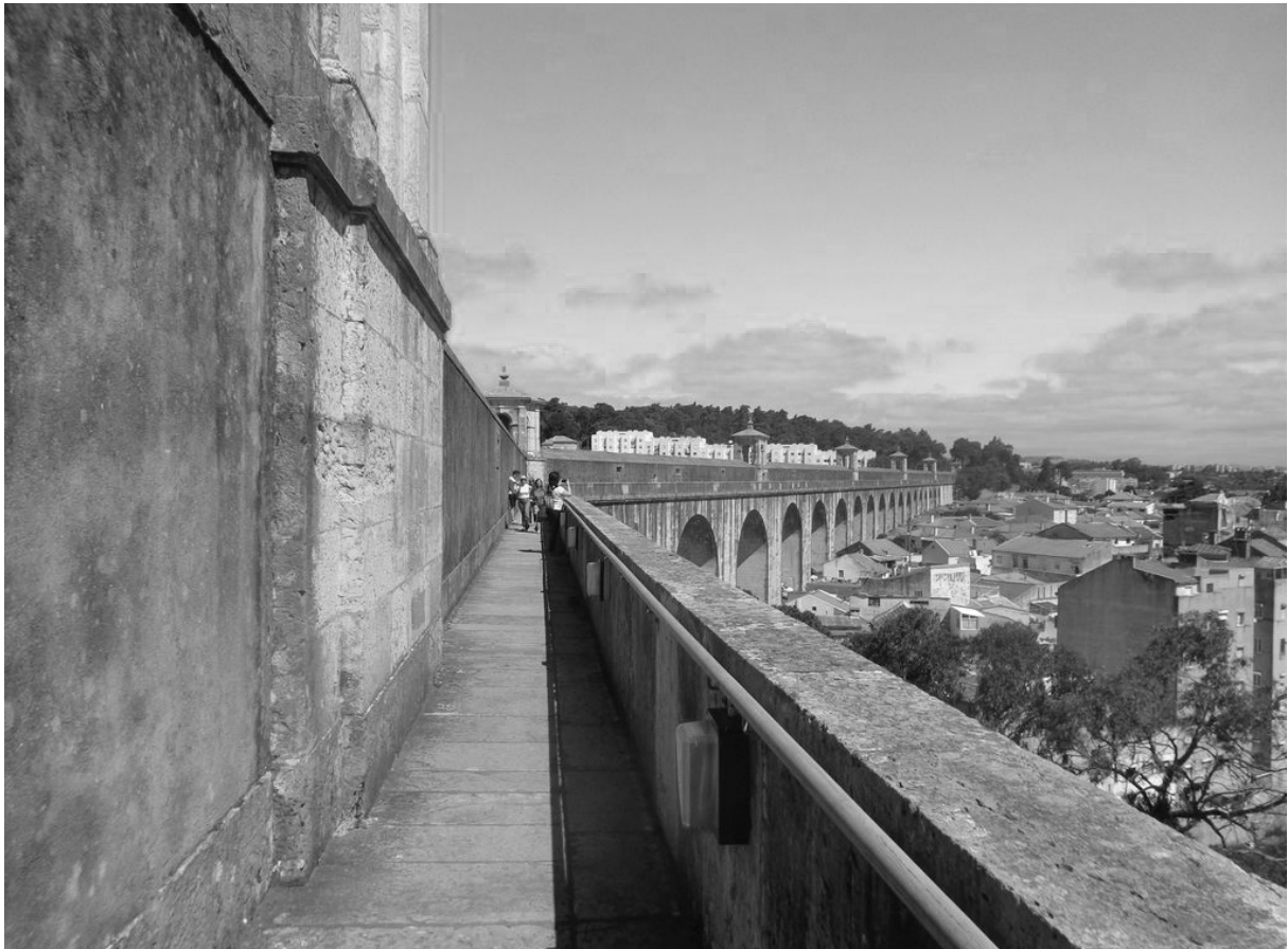
Figura 1 - O Aqueduto das Águas Livres desenhado sobre o vale Alcântara para providenciar a distribuição da água pela cidade cumpre também a função de travessia pedonal à mesma cota entre as encostas que balizam o vale. adaptado de: https://caminhando.pt/eventos/visita-travessia-do-aqueduto-das-aguas-livres/
