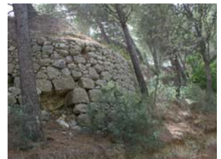
Figura 70 – desmoronamento de parte da parede do forte (CONDE, C., 2007)
