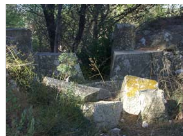
Figura 34- exemplo de desmoronamento de uma das canhoneiras do forte n.º 114 b) (CONDE, C., 2007)
