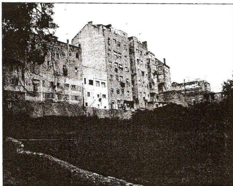
O Bairro da Liberdade, em Campolide, está em risco de derrocada e milhares de habitantes estão preocupados
