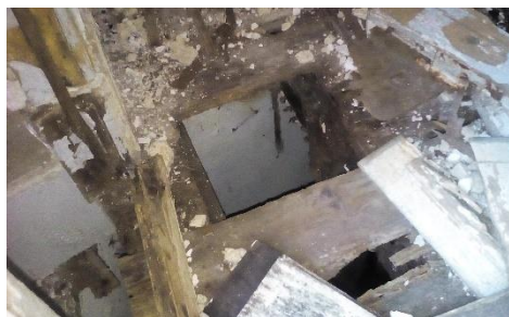
Figura 18: Pavimentos em madeira num avançado estado de degradação
