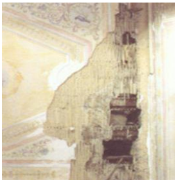
Figura 53: Elementos pictóricos dos tetos em ruína
