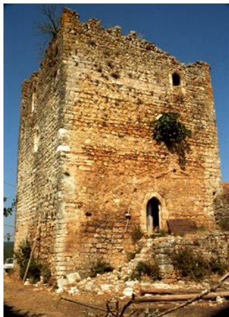
Figura 40: Torre em estado de abandono com escadaria quase inexistente
