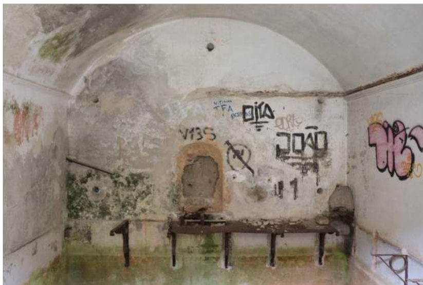
Figura 71 – Interior. Degradação da cisterna da Bateria de Alpena, 2019. Fotografia do autor.
