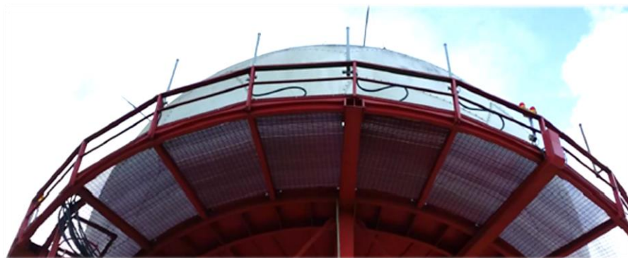
Figura 3.3 – Antenas VHF no varandim do sistema SSR (Estação Pico Alto)
