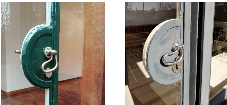
Figuras 202 e 203 – Portas de vidro com acesso ao exterior, 2019. Casa Esters, à esquerda e Casa Tugendhat, à direita. Semelhança nos elementos metálicos.
