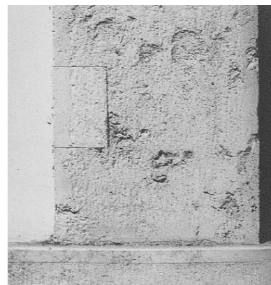
Figura 13: Recuperação de falhas
