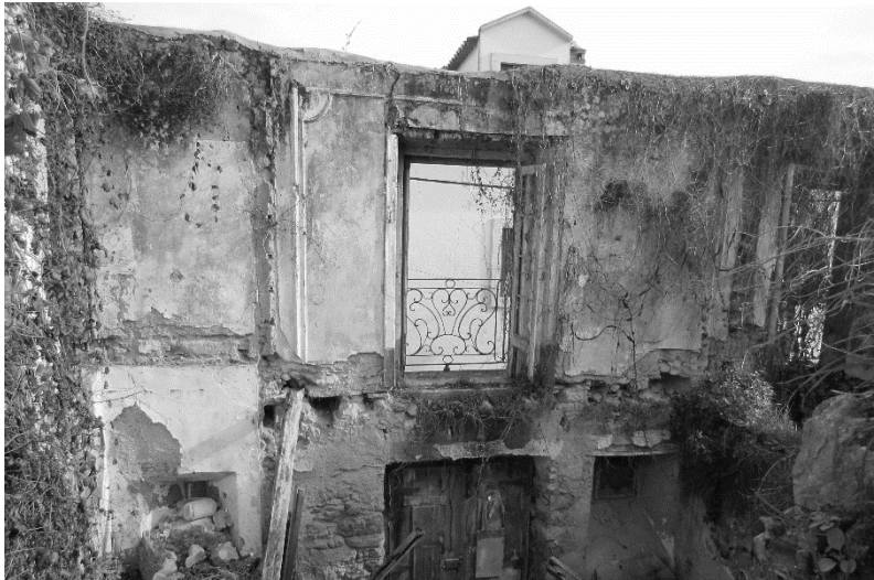
Vista do interior do quarteirão. Estado da fachada sudeste.
