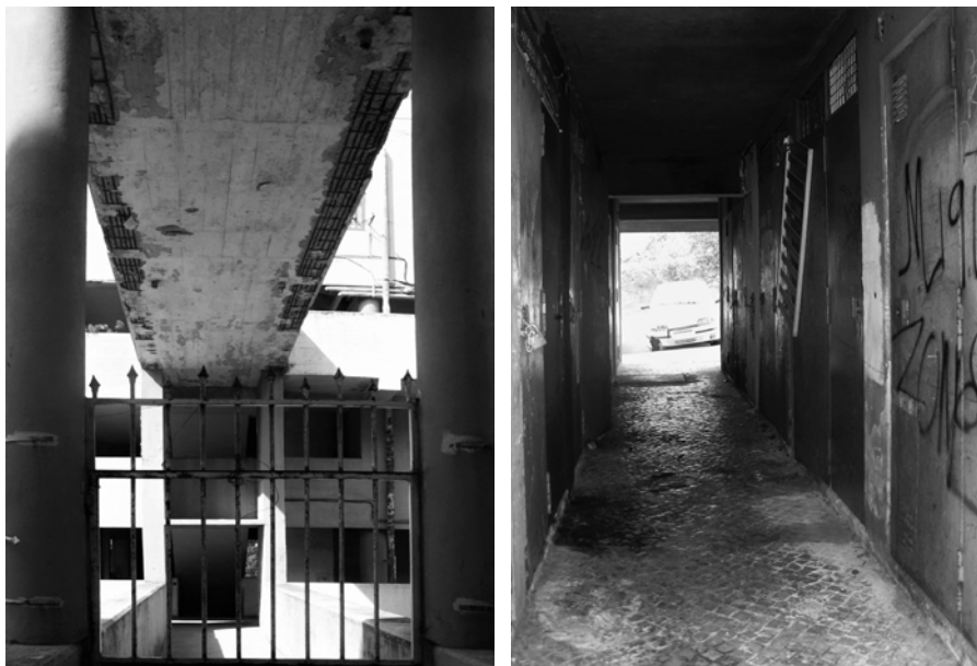
Figuras 16 e 17. Pantera Cor-de-rosa, identificação das patologias. (Fonte: Fotografias dos autores, 2011)
