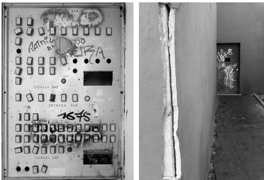
Figuras 14 e 15. Zona J, identificação das patologias. (Fonte: Fotografias dos autores, 2011)
