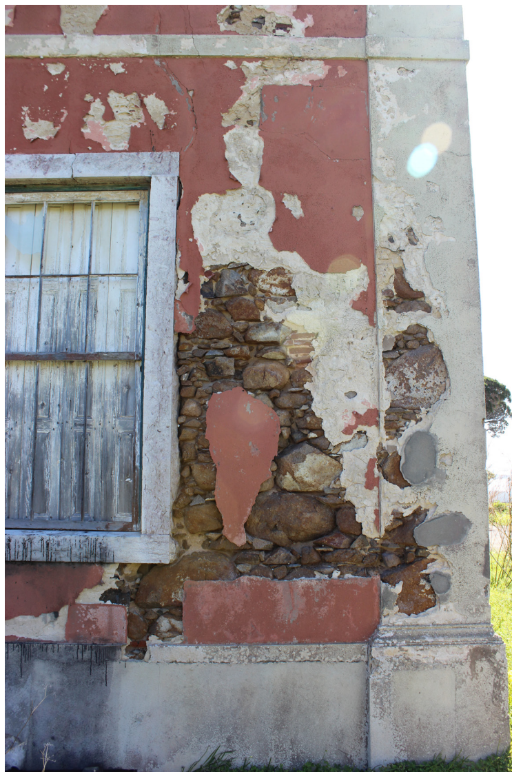
Lacuna no reboco no alçado Oeste da casa
