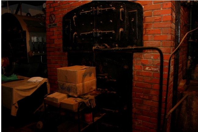
Foto 32 Casa das caldeiras de aquecimento das águas
