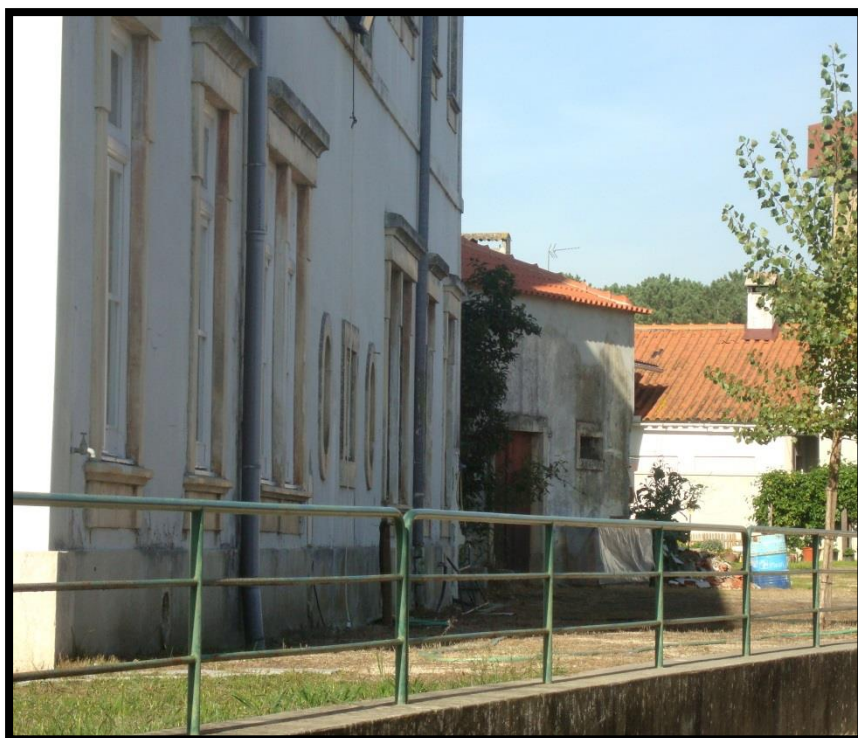
Img. 10 – parte de trás da escola por recuperar
